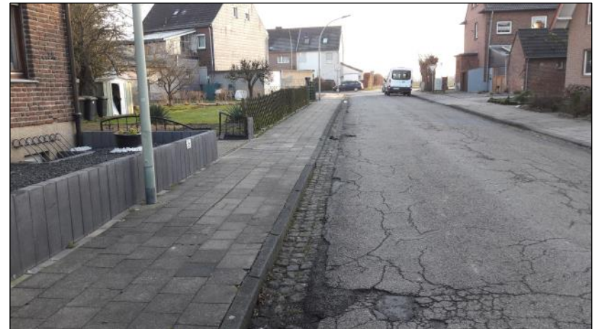
Bild 2: Schadhafte Rinne, Unebenheiten im Gehweg
