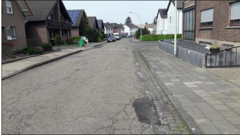
Bild 5: Flickstellen im Fahrbahnbereich
