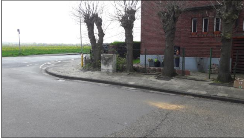
Bild 3: Beschädigung Gehweg durch Wurzeln
