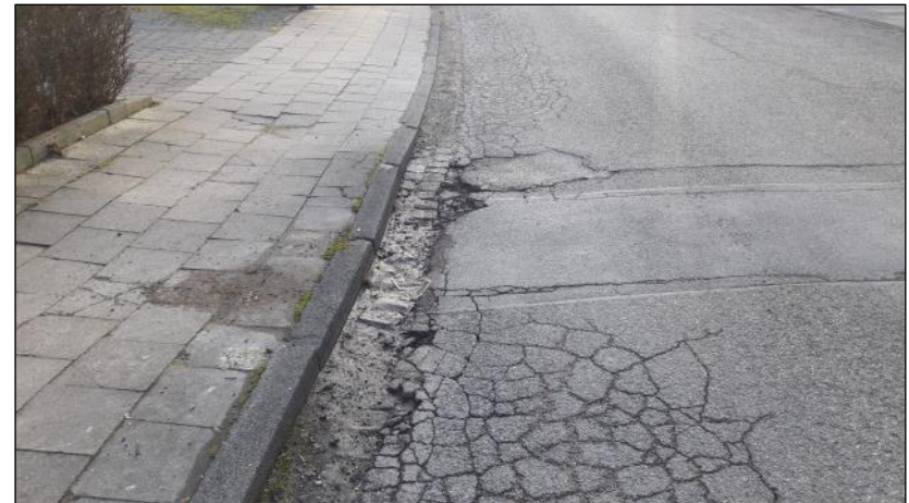
Bild 4: Schadhafte Straßenentwässerung, Pfützenbildung
